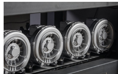
4 bombas de vacío
